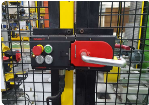
출입문 연동장치 및 잠금장치
